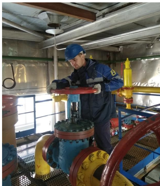
Рисунок 2 – Перекрытие потока нефти
